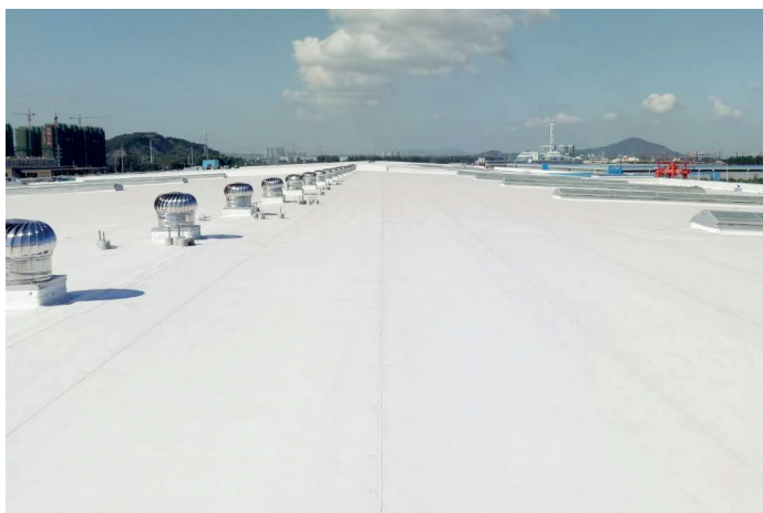
Usine de Nio automobile - Chine - Nankin - 2017 - 26 000 m 2 de Flagon® Energy+ EP/PR
